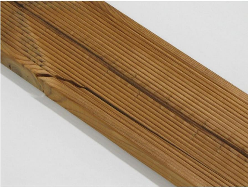
Dopuszczalne są poważne pęknięcia.
